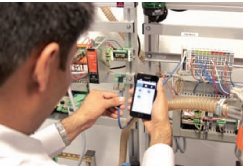
Abb. 3: Dezentrale Überwachung und Steuerung von Anlagen über mobile Endgeräte
